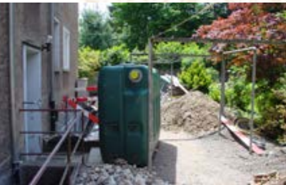
Regenwassertank, Haus Im Heimat- land 11
