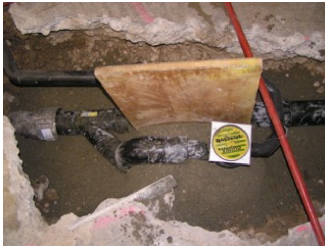
Abwasserleitungen in der Waschlüche Haus 19
